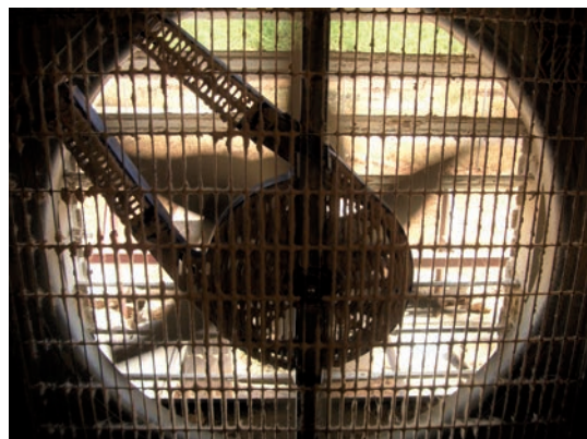
Detalle de la suciedad acumulada en un ventilador
