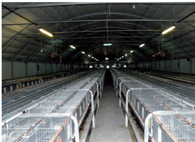
Localización de luminarias en una nave de maternidad
