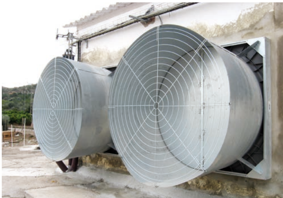
Foto 1. Ventiladores axiales de alto caudal con cono
